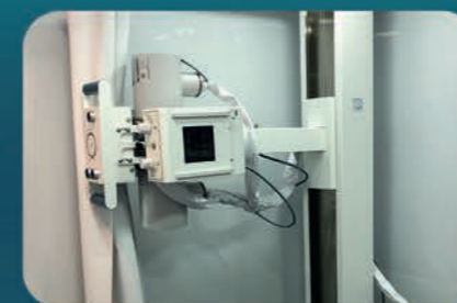
Interior de Unidade Móvel de Raio-X
